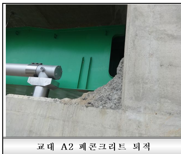
【표 2.1-8】 교대 및 교각 손상물량
