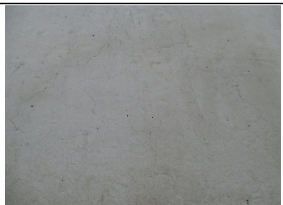
P4 교각 망상균열
