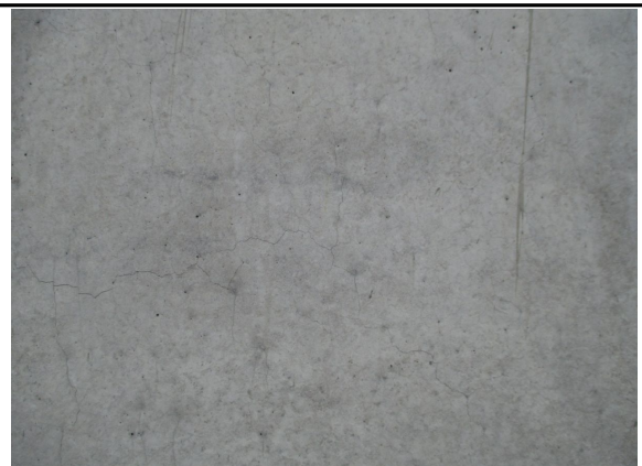
P3 교각 망상균열
